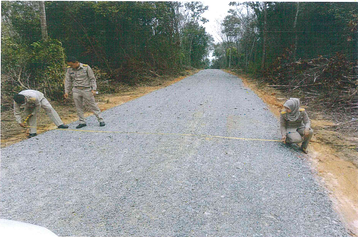
โครงการบุกเบิกถนนสายแยกจากถนนสายแวง – สุคิริน ถึงถนนบาตูกาเยาะ 1 หลังดำเนินการก่อสร้าง
