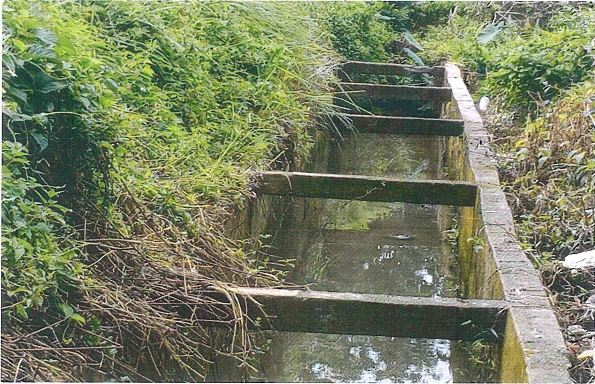
โครงการปรับปรุงก่อสร้างระบายน้ำสายปะจुरอยะ ก่อนดำเนินการก่อสร้าง
