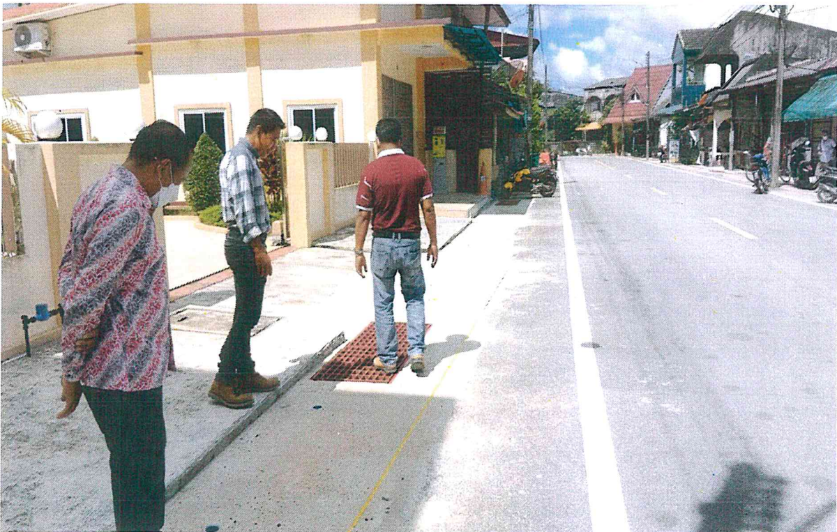
โครงการก่อสร้างระบายน้ำสายมัธยมิตตาราม หลังดำเนินการ
