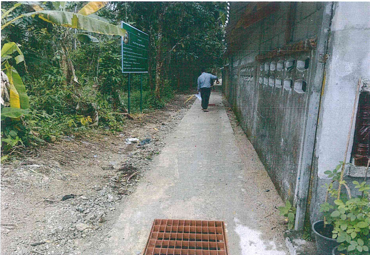
โครงการปรับปรุงก่อสร้างคูระบายน้ำคอนกรีตเสริมเหล็กสายกุงถึงคูระบายน้ำหลังชุมสายโทรศัพท์ หลังดำเนินการก่อสร้าง
