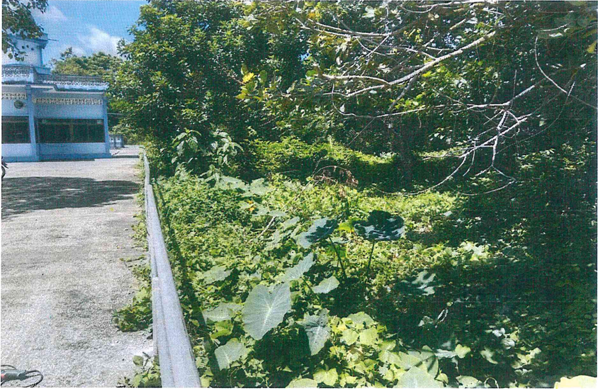
โครงการก่อสร้างระบายน้ำคอนกรีตเสริมเหล็กสายข้างมัธยมเราะห์มานียะห์ ก่อนดำเนินการก่อสร้าง
