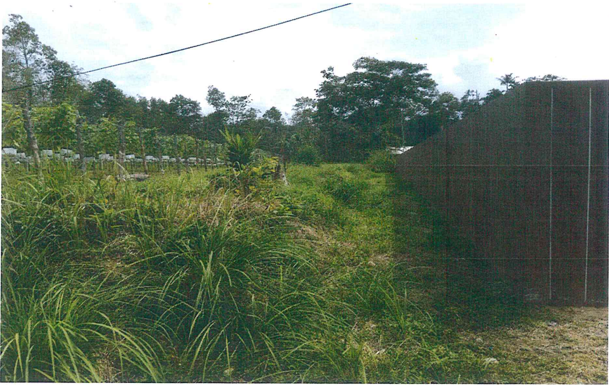
โครงการบุกเบิกถนนสายแยกจากถนนสายแวง – สุคิริน ถึงถนนบาตูกาเยาะ 1 ก่อนดำเนินการก่อสร้าง
